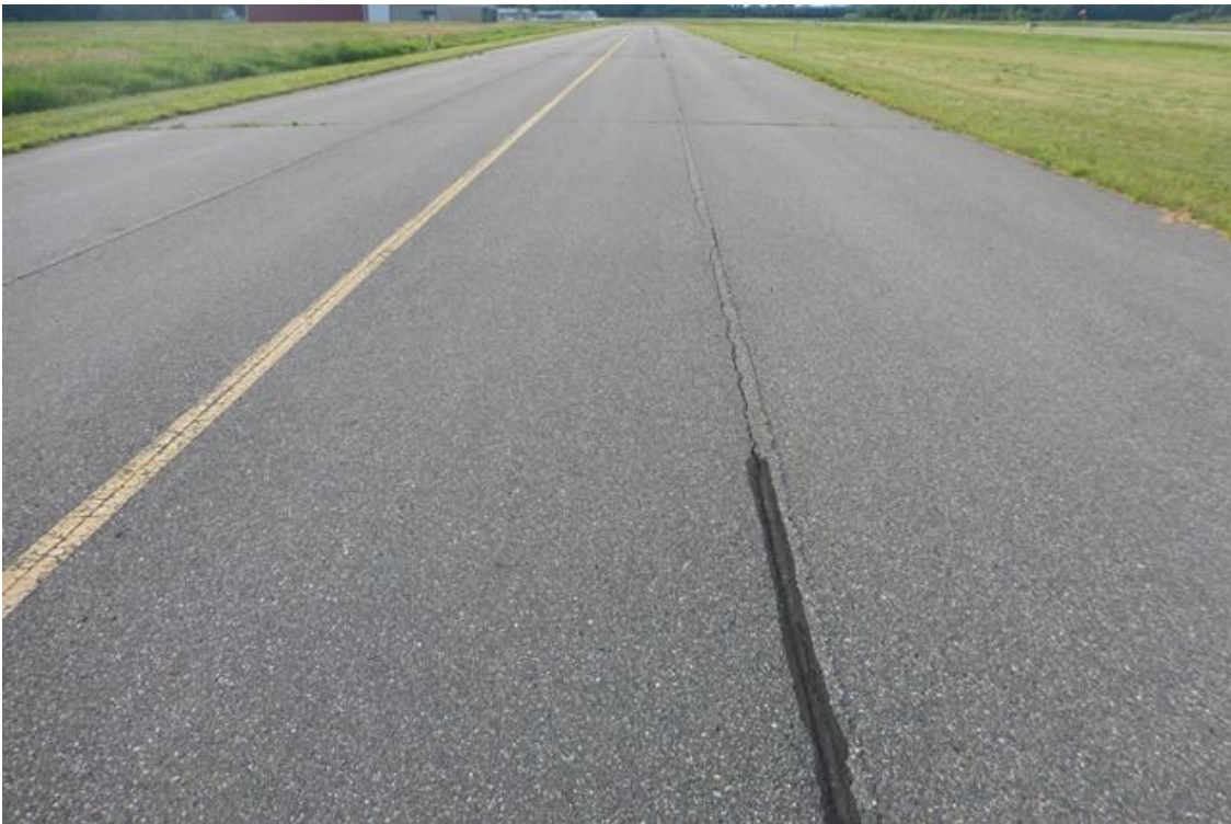
PWC PTA 002 (PCI = 71)
