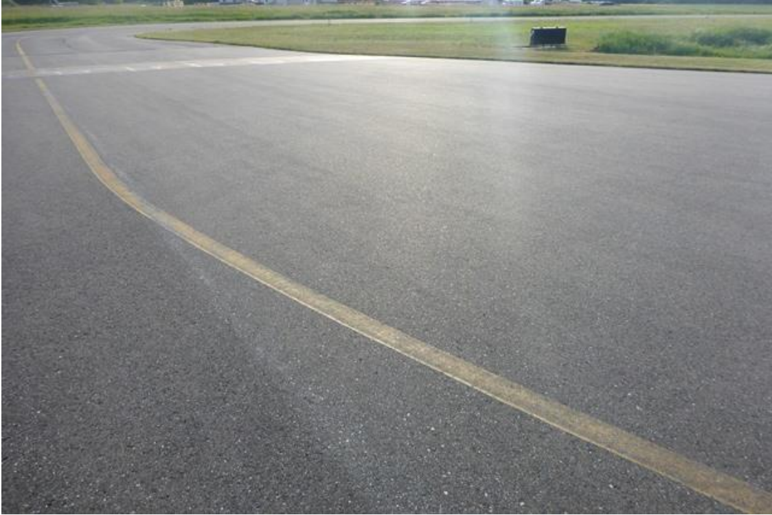
PWC PTA 001 (PCI = 86)
